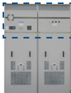
Low Voltage Compartment Scomparto di Bassa Tensione
