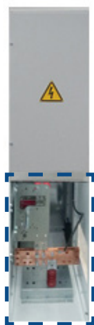
Disconnectors Compartment Scomparto Sezionatori
