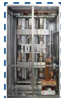
Bus bars Compartment Scomparto sbarre e sezionatore
